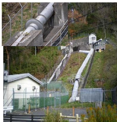
150kW 岩泉町、一般河川
