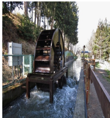
0.8kW 松本市、農業用水
