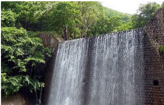
東鴉川第三砂防堰堤 (小水力発電 140 kWを設置)
